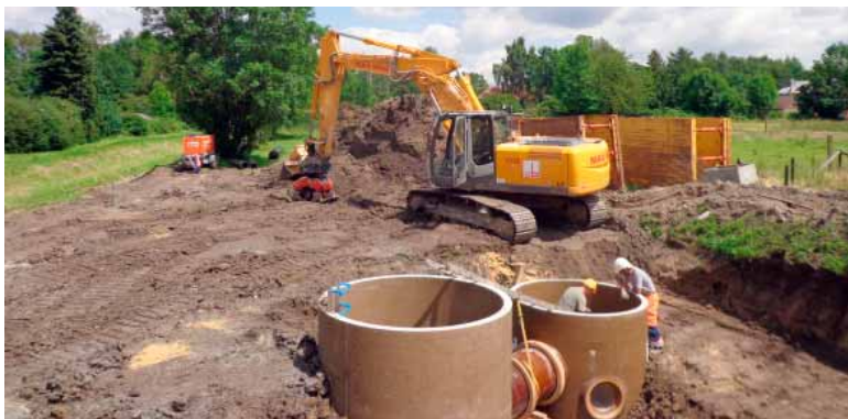
Nicht zuletzt die hohe Korrosionsbeständigkeit war beim Bau des Pumpwerkes ausschlaggebend für die Wahl des Werkstoffes Polymerbeton.
